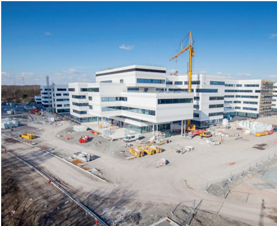
Comme l'an dernier, le chantier de la monumentale clinique MontLégia sera notamment à visiter.
